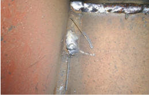
Resim 1.30: Yüzey temizliği yapılmadan kaynak
