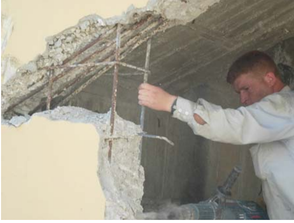
Fotoğraf 4. Bir kolon kiriş bağlantı yerindeki boşluk.
