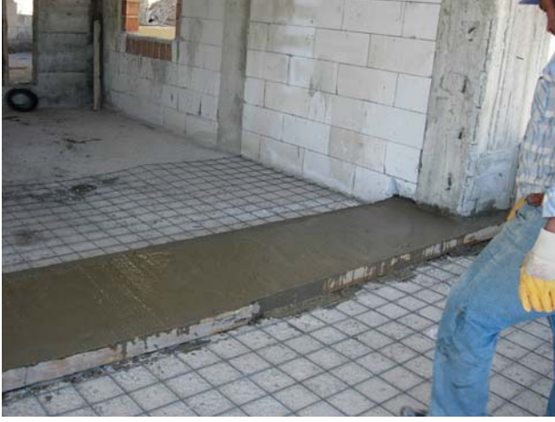
Fotoğraf 18 Fotoğraf 6 ve 7 de gösterilen çelik konstrüksiyon yerine yapılan güçlendirmenin son durumu.
