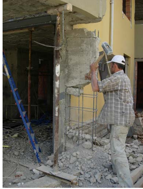
Fotoğraf 2. Hatalı yapılan bir kolonun kırılan betonu.
