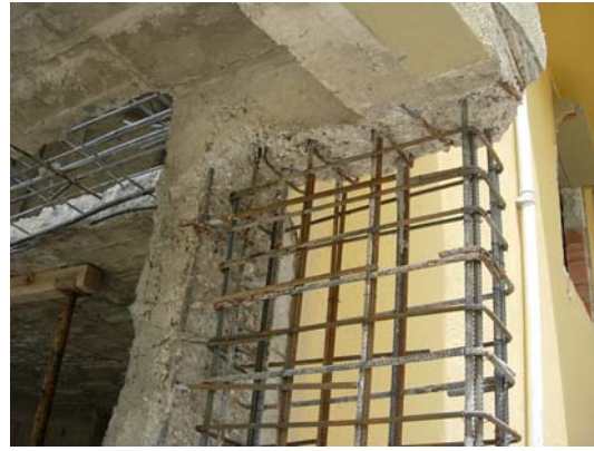
Fotoğraf 15. Fotoğraf 1,2 ve 3 deki kolonun yenilenmesi.
