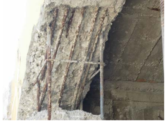
Fotoğraf 5. Bir kolon Kiriş bağlantı yerindeki boşluk ve donatı düzenlemesi.
