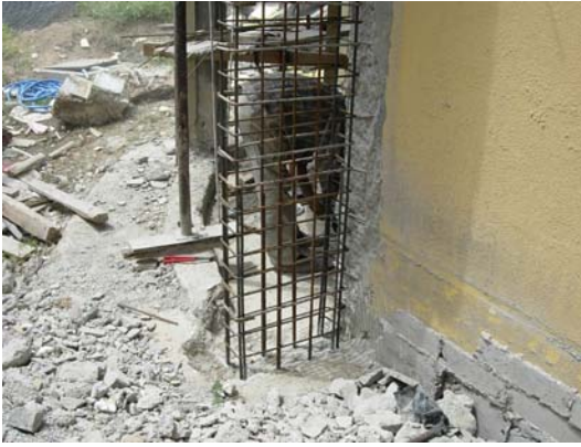
Fotoğraf 14. Fotoğraf 1,2 ve 3 deki kolonun yenilenmesi.
