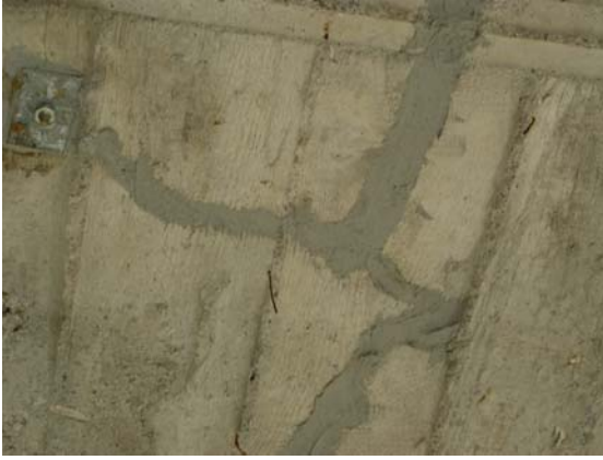
Fotoğraf 10. Döşemede güçlendirme sırasında oluşan çatlaklar.
