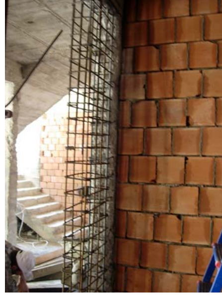
Fotoğraf 13. Kırılarak ilave yapılmış bir kolondan görünüm.
